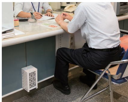
床の清掃を考慮し金具で浮かせて設置しています
